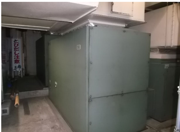
老朽化したボイラー設備
