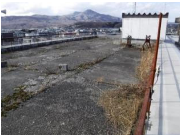
老朽化等により剥離やひび割れなどが発生している 現庁舎屋上
