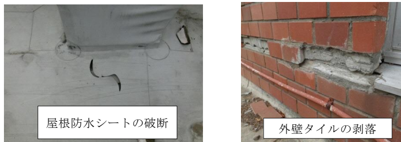
図 5-1 劣化度 C 「機能維持に補修が必要」の事例
