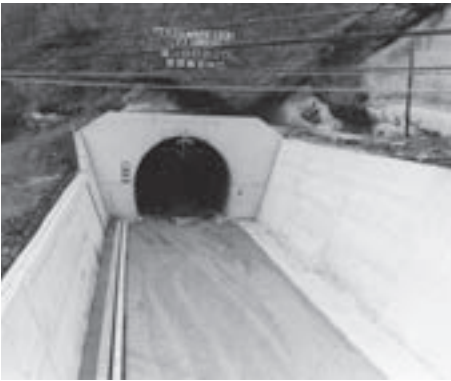
▲線路の敷設を待つ蘭法華トンネル (登別側・昭和54年撮影)
