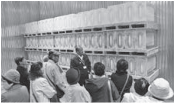
▲安定した氷の供給を行うための製氷・貯氷施設(登別漁港内)
