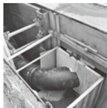
▲道路冠水を軽減させるため、計画的に実施している排水路整備
