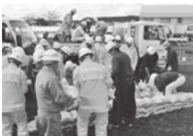
▲地震で破損した箇所を土のうを設置し、河川の氾濫を防ぐ『土のう設置訓練』
