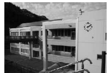
室蘭市 星蘭中学校太陽光パネル
