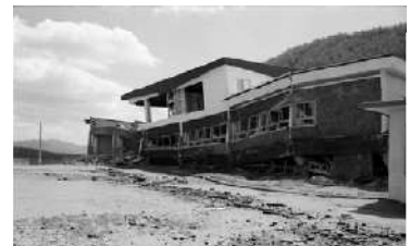
半倒壊した病院
