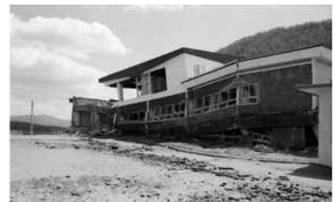
半倒壊した病院
