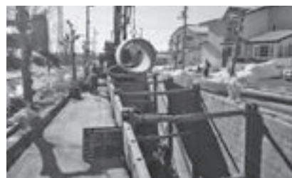
▲下水道事業では、雨水の浸水対策として雨水管渠の整備も行う
