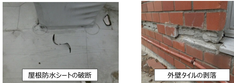
図 3-1 劣化度C「機能維持に補修が必要」の事例
