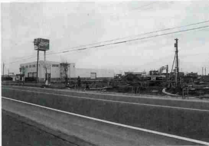
▲4月3日から業務開始する北海道コカコーラボトリング室蘭登別統括営業所と、6月完成を目指し工事着工したレンタル業のナガワ(緑町1丁目)
