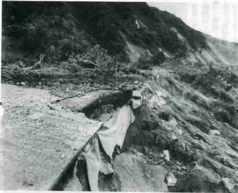
土砂が崩れ、路肩は大きくえぐられた国道36号線、富浦付近
