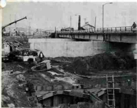
交通量の増大にともなって改良されている来福橋拡福工事。
