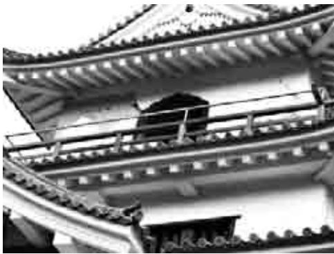
▲震災で外壁がはがれた白石城
