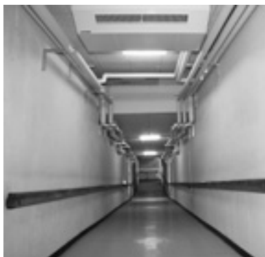
▲入園者に支障のないよう天井に 設置した給湯管と給水管
