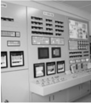
▲幌別浄水場計装盤
