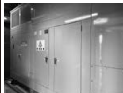
▲非常用発電設備
