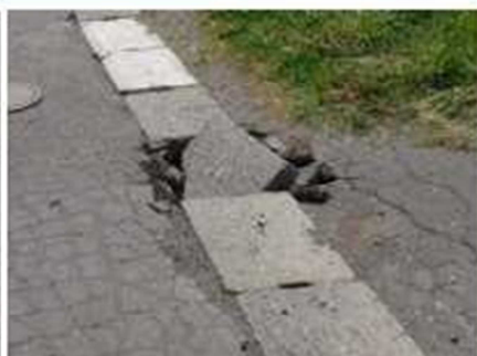
側溝のふた破損
