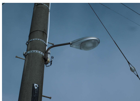
防犯灯（水銀灯）
