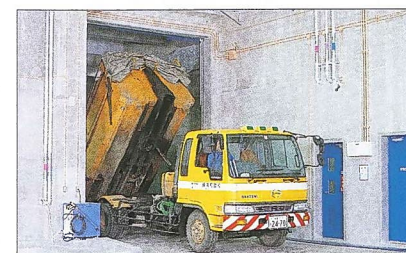
汚泥受入貯留槽 汚泥は計量後、汚泥受入貯留槽に投入します。
