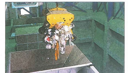
クレーン・ごみ投入ホッパ ごみはいったん貯留され、ごみクレーンにより投入ホッパに投入します。
