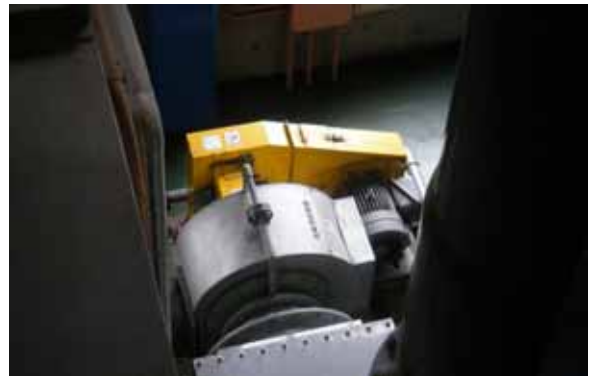
写真 6 脱臭用排風機
