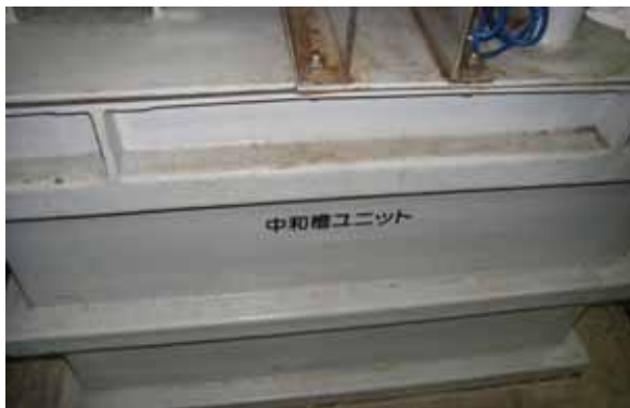
写真 9 中和槽ユニット
