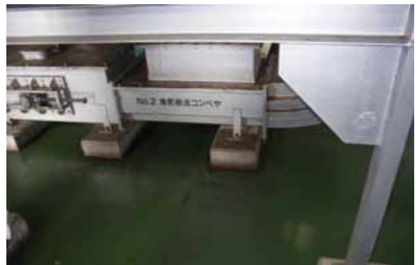
写真 11 No.2 堆肥搬送コンベア
