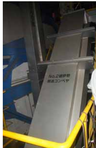
写真 17 No.2 破碎物搬送コンベヤ
