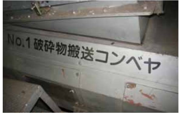
写真 16 No.1 破碎物搬送コンベヤ
