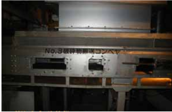
写真 19 No.3 破碎物搬送コンベヤ
