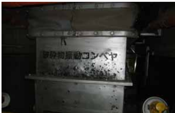
写真 15 破碎物振動コンベヤ
