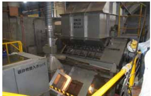
写真 11 一次破砕機・破砕物受入ホッパー
