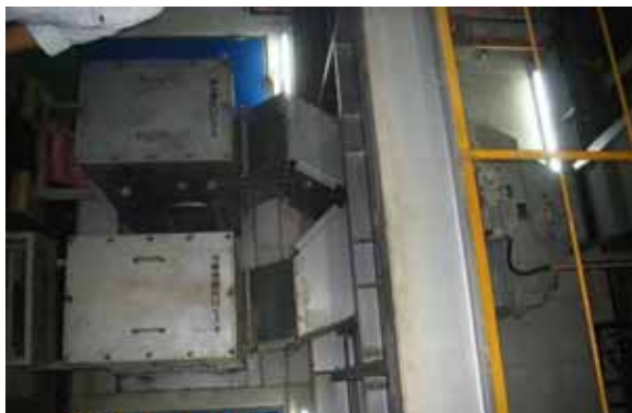
写真 26 不燃物搬出コンベヤ
