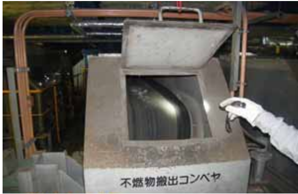
写真 25 不燃物搬出コンベヤ
