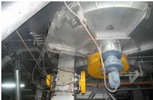
写真 14 ガス冷却室 (ガス冷灰搬出装置)
