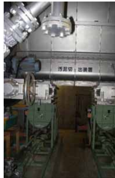
写真5 汚泥切り出し装置
