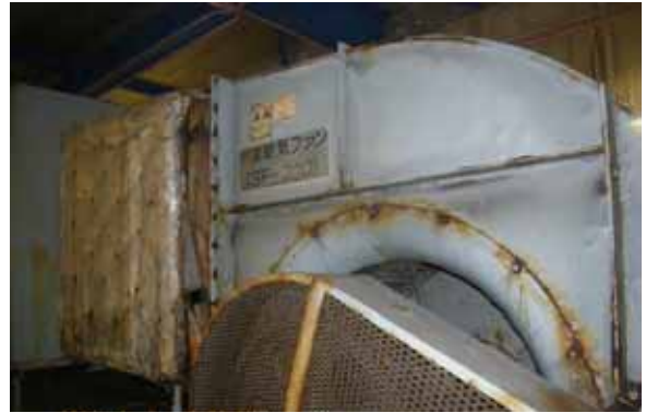
写真 28 炉室給気ファン
