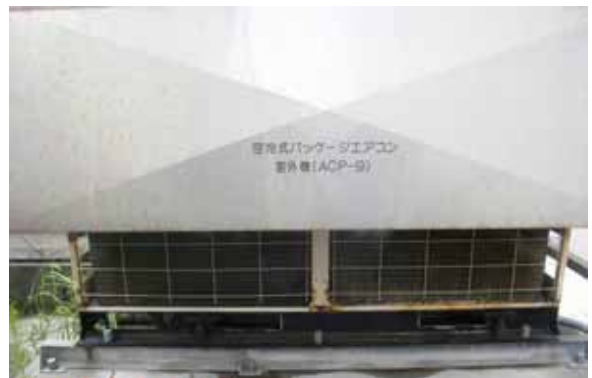
写真 30 エアコン室外機
