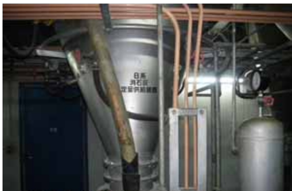
写真 27 消石灰定量供給装置
