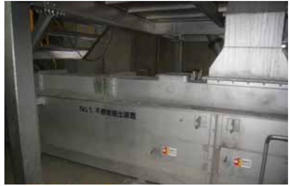
写真 22 不燃物搬出装置
