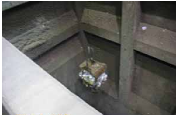
写真2 ごみクレーン
