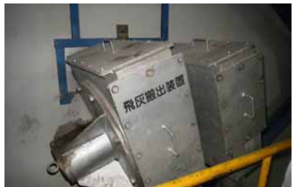
写真 18 飛灰搬出装置
