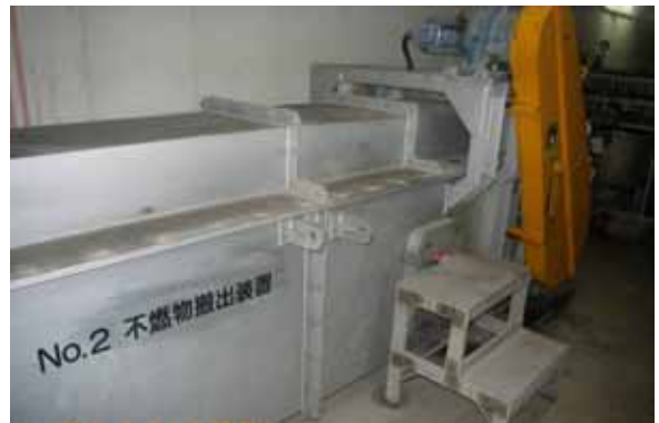
写真 23 不燃物搬出装置
