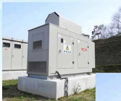
▲非常用発電機
