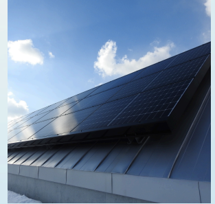
▲ 太陽光パネル
