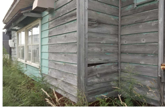
外壁 塗装劣化・剥離
