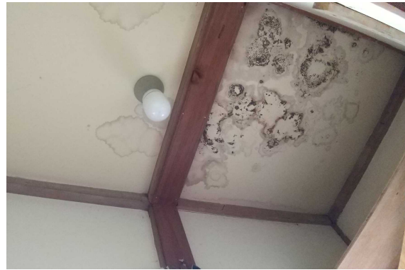
トイレ 天井漏水あと・カビ
