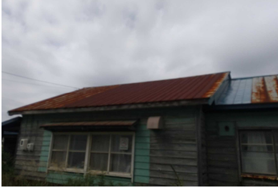
屋根 塗装劣化・さび
