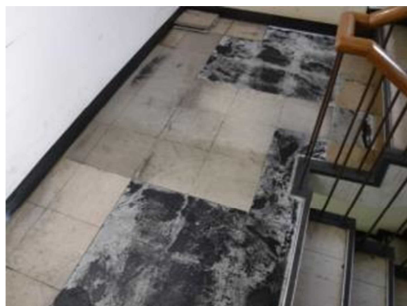
現庁舎階段踊り場の床タイルが剥離
