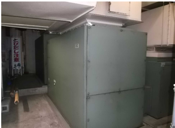
老朽化したボイラー設備
