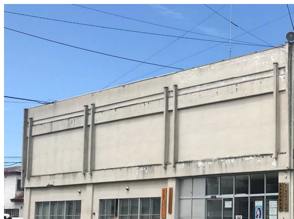
第2庁舎においても老朽化が進み、外壁コンクリートの剥離が発生
