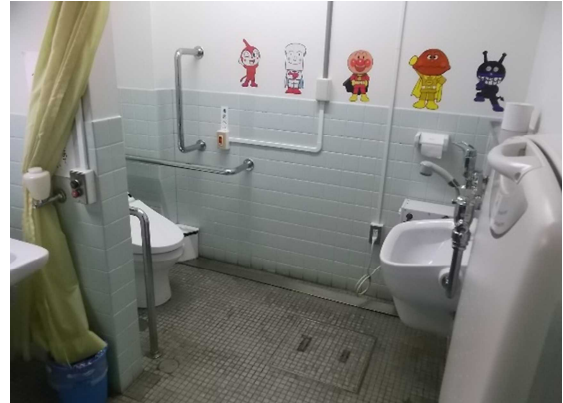
多目的トイレ（1階のみ設置）
