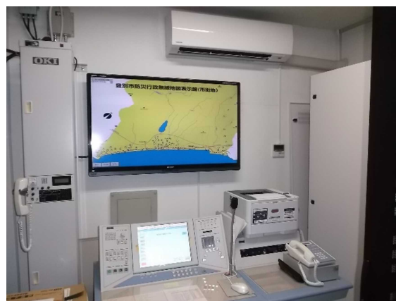
防災行政無線システム
