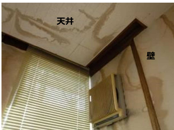
現庁舎内で慢性的に雨漏りが発生し、雨漏りで壁クロスが変色
