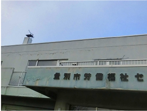
玄関 庇ひび割れ・塗装劣化
