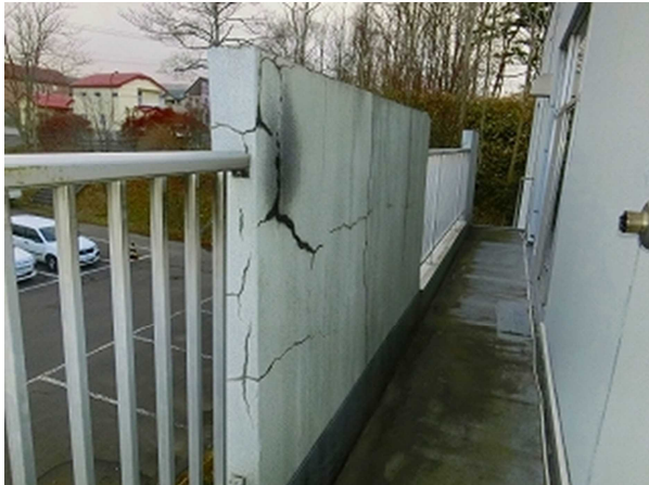
バルコニー 手摺壁曝裂・ひび割れ・防水劣化
