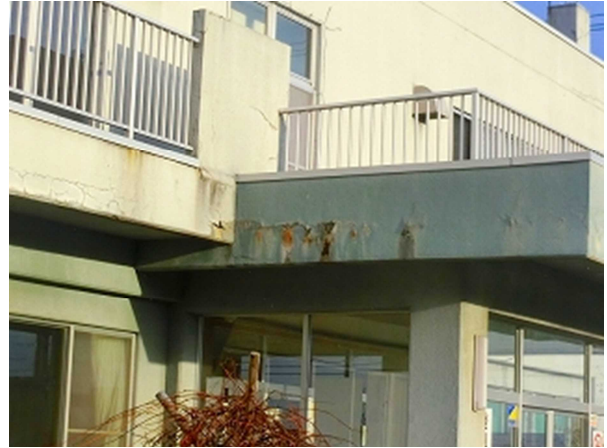
玄関 庇壁ひび割れ・錆あと・塗装劣化 バルコニー ひび割れ
