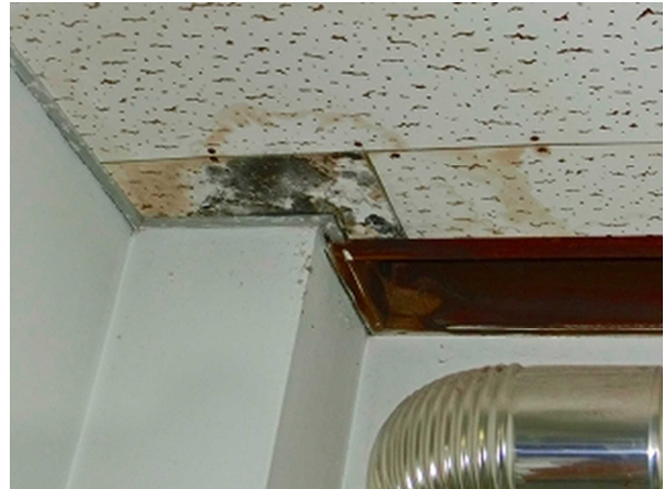
調理実習室 天井漏水あと・カビ
