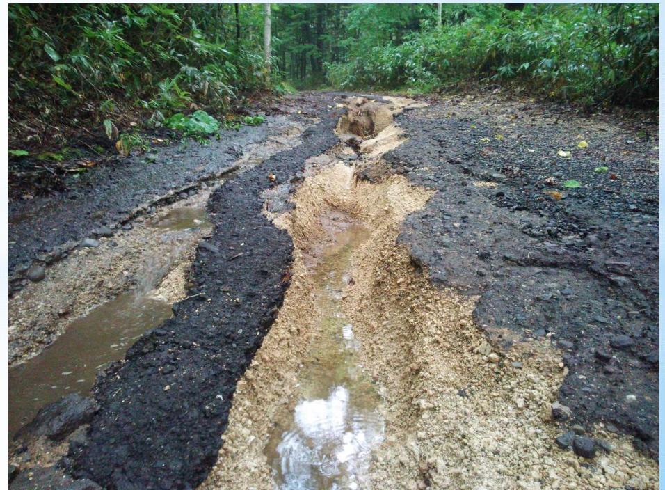
大雨による被災状況
