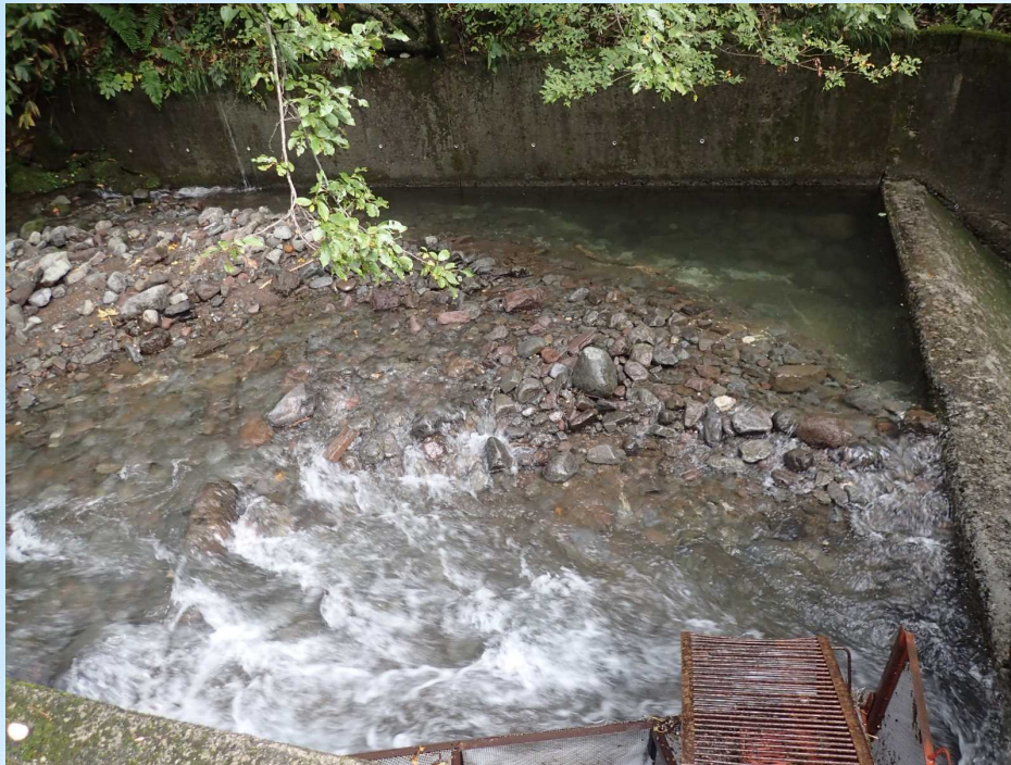
取水口閉塞状況
